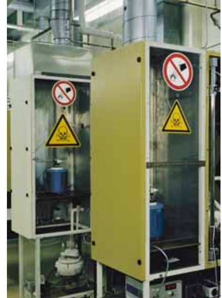
Bild 20 Raum, in dem die Sicherheitszeichen «Löschen mit Wasser verboten» und «Warnung vor giftigen Stoffen» unmittelbar bei den Gefahrenstellen angebracht sind.
