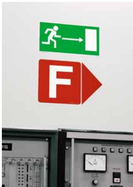
Bild 21 Kennzeichnung des Rettungswegs, kombiniert mit der Kennzeichnung des Wegs zum Material für die Brandbekämpfung.
