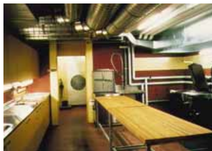
Bild 29 Raumbeleuchtung durch Fluoreszenzlampen.
